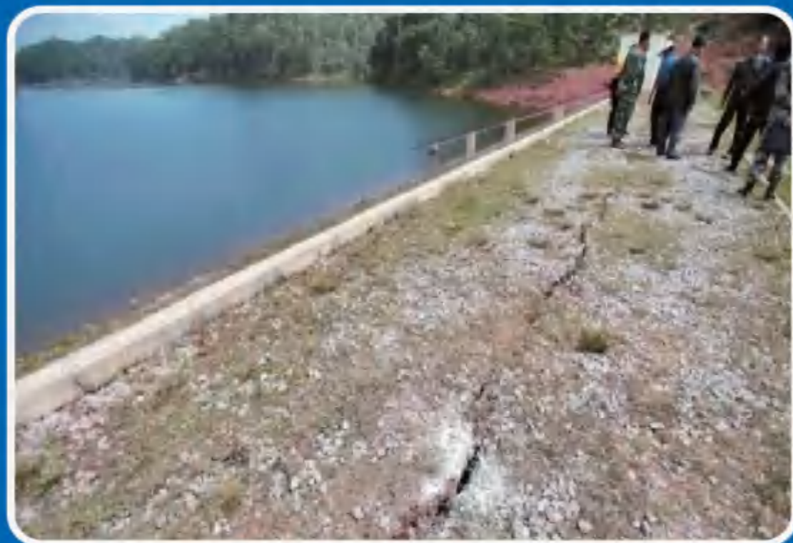
水库大坝坝身出现裂缝,造成渗水、漏水严重或出水浑浊
