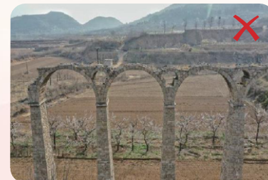
灌区渡槽结构主体裂缝多,碳化破损严重,止水失效,漏水严重
