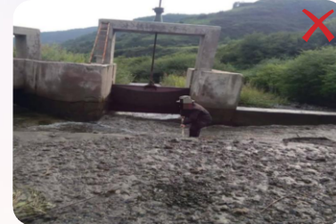
水库大坝泄水建筑物堵塞无法泄洪
