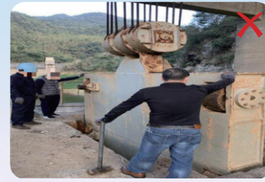
水库大坝闸门主要承重件出现裂缝、门体止水装置老化,闸门在启闭过程中出现异常振动或卡阻
