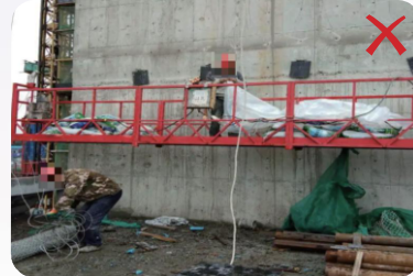
施工吊篮未经检测、验收或无独立安全绳
