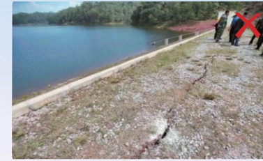
水库大坝坝身出现裂缝,造成渗水、漏水严重或出水浑浊
