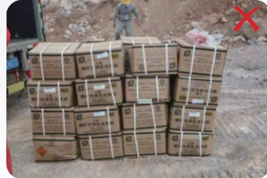
爆破作业时使用非专用车辆运输民用爆炸物品或人药混装运输
