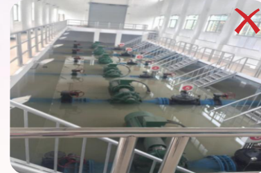
水电站厂房渗水至设备、电器装置
