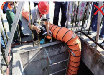
开展有限空间作业、动火作业等危险作业时未落实安全措施
