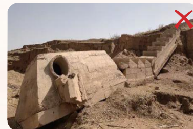
淤地坝泄水、放水设施(溢洪道、卧管、竖井、涵洞、涵管等)局部损毁或出现坍塌、断裂、淤堵、掩埋、基部淘刷悬空
